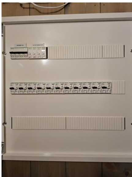
Elektrisk anlegg - [Sikringsskap]
