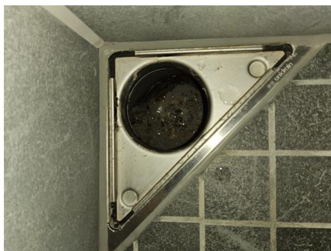
Avløpsrør (ink. sluk) - [Sluk, bad 3.etasje]
