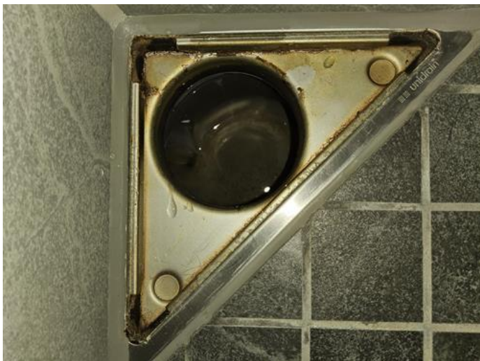
Avløpsrør (ink. sluk) - [Sluk, bad 4.etasje]
