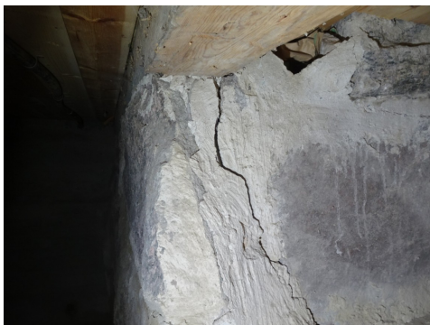
sprekker i gråsteinsmur nordre side mot tilbygget
