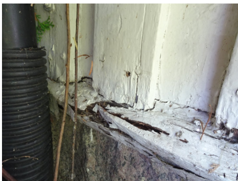
råteskade ved sørvestre hjørne
