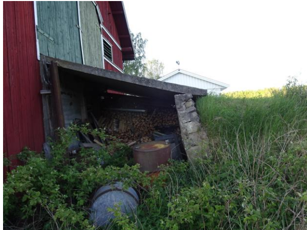
Støtte og bæremuren må rettes opp.
