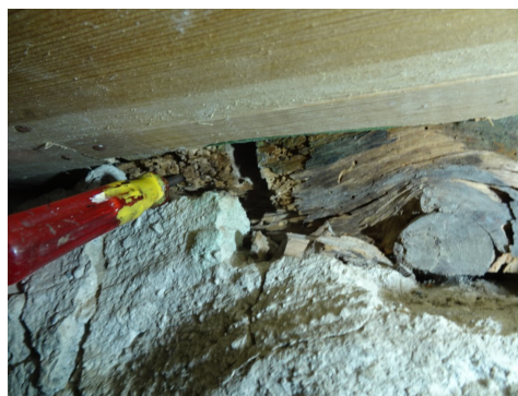
råteskade i del av stokk
