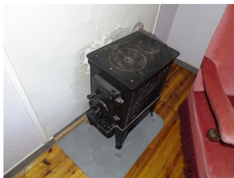
liten vedovn 2 etg tilsluttet teglsteinspipen
