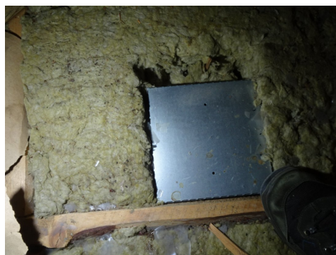
Spotlightbokser uten tildekking med isolasjon på loftet (1975 side)
