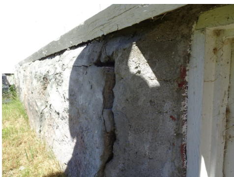
sprekker i gråsteinsmur vestre side
