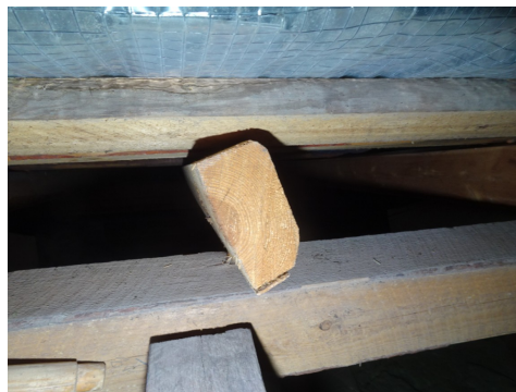
Enkelte taksperre som har lagt seg litt over/vridd seg noe
