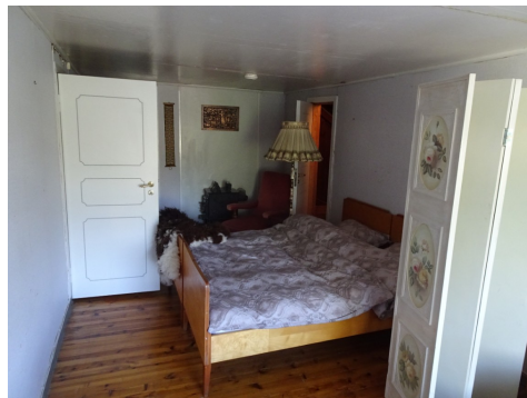
soverom 2 etg. som har størst skjevhet i gulvet
