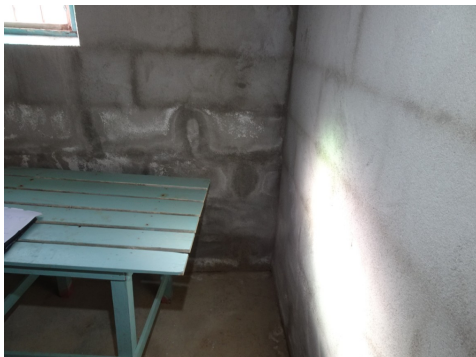
Fuktskjolder, saltutslag sees
