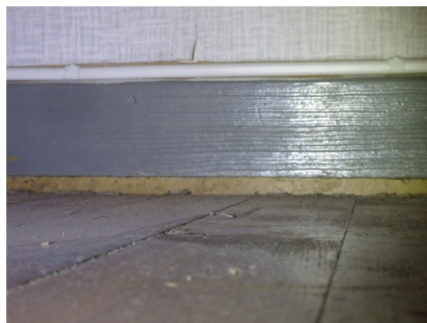
bilde viser åpning mellom gulvlist og gulv
