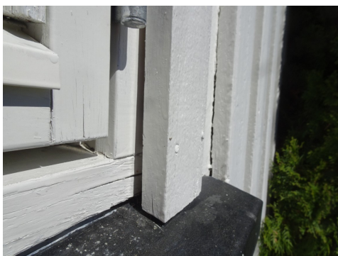
slitasje sees, sidebelistning åpen
