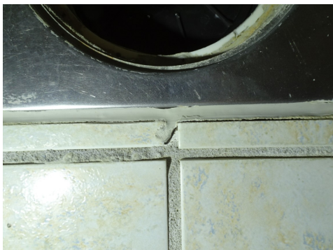
fuge ved slukrist
