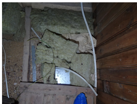
Spotlightbokser uten tildekking med isolasjon på loftet (1850 side)
