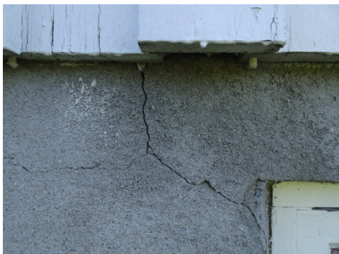
sprekker ved vindu fasade nord
