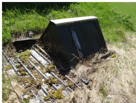
et lite brønnhus over borebrønnen
