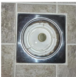
Avløp (inkl. sluk) - Sluk i dusjsonen
