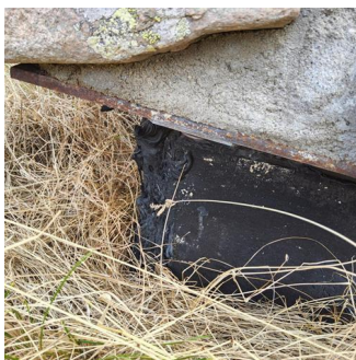
Helhetsvurdering - Ufagmessig tetting ved pipe/torvtak
